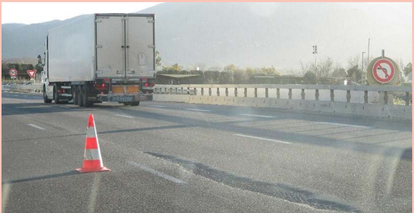
Dégradation du BBTM sur l'A9 au Boulou, 04/02/2020, Cyrille Courier
