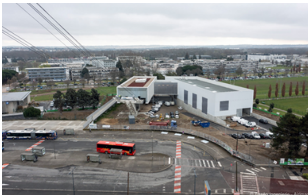
Pôle d'échange Paul Sabatier à Toulouse : à gauche accès métro et le pôle bus, au centre la station Téléo et à droite le garage de maintenance ©Tisséo.
