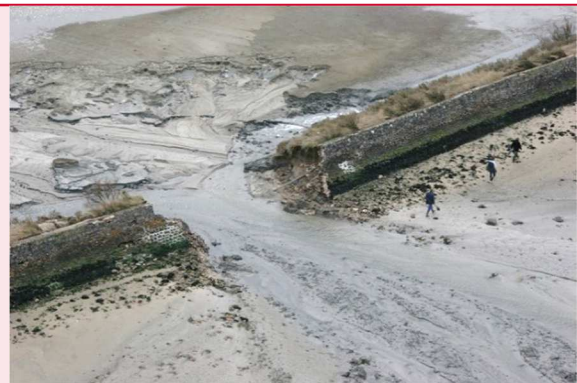
Brèche sur une digue à Guérande (44) - CETE Sud-Ouest
