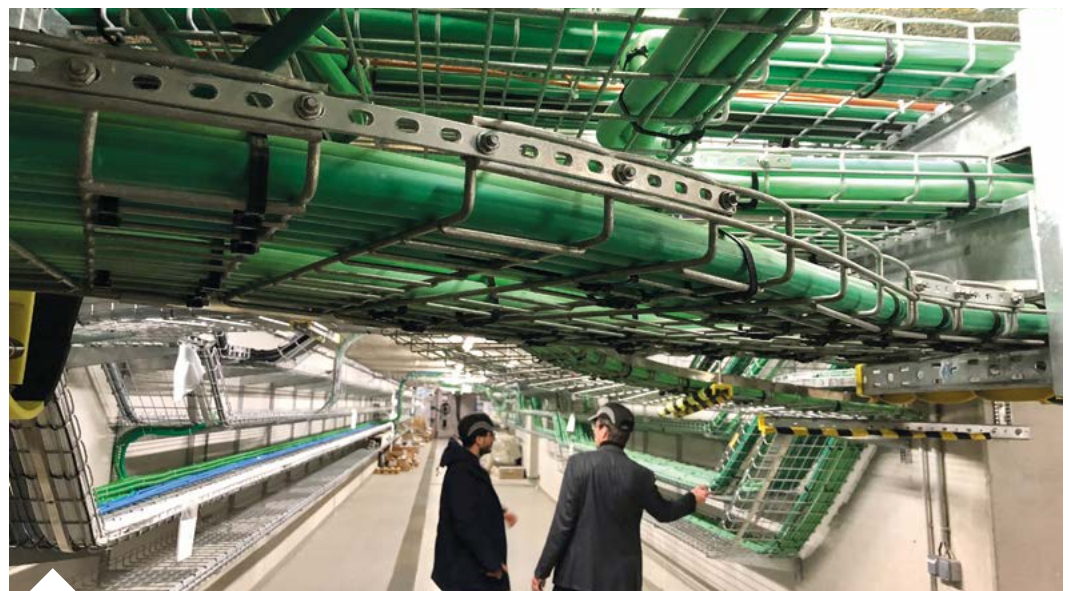
Siège du SNA Nord-Est à Strasbourg : réseau de câblages.
