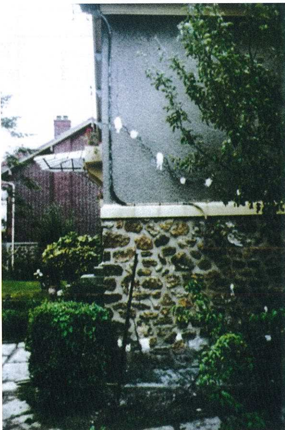
Photo 10. Fissuration due à un tassement différentiel modéré d'un angle d'habitation en maçonnerie de meulière et briques avec enduit.
